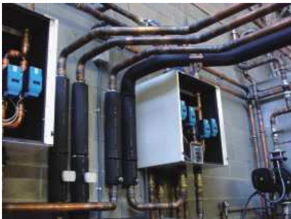
Instal·lació amb subministre d'energia geotèrmica a Can Marcet
