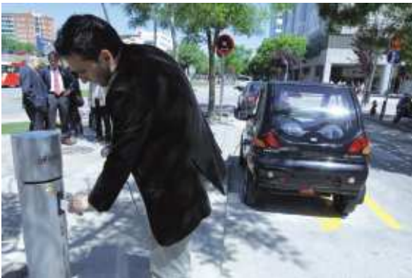
Punt de recàrrega per a vehicles elèctrics a la via pública
